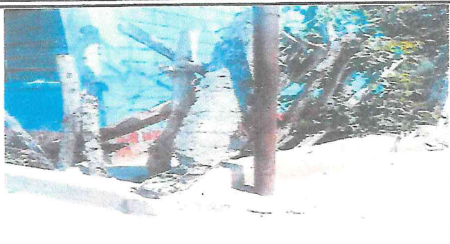
Foto 1: . En esta foto aparece la columna de la esquina que conduce a la calle principal donde se puede observar que la columna esta quebrada sostenida de unos orcones de madera.
