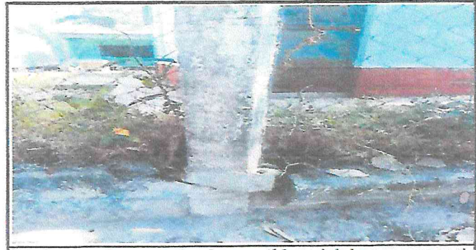
Foto 6: aca se observa que la columna está fuera de la base ya se ve en el aire.
