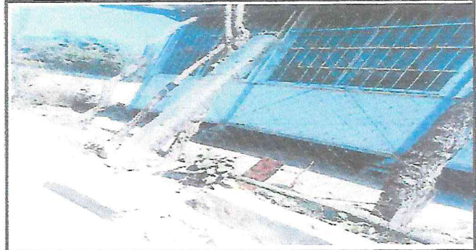
Foto 4: en esta fotografía se muestra que desde la parte de abajo esta quebrado tanto columna como solera -
