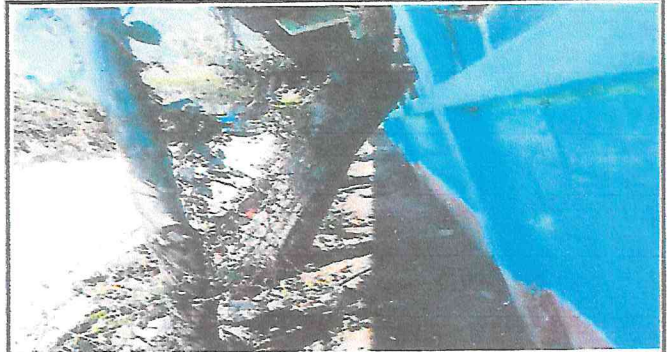
Foto 2: en esta fotografía se puede observar otra columna detenida en la pared del aula donde esta quebrada desde abajo.
