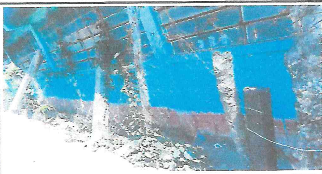
Foto 3: aca en esta fotografía aparecen varias columnas detenidas en la pared del salon de clases donde es un peligro para los estudiantes.
