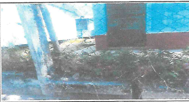
Foto 5: aca se ve como está rajado de donde está el sostén de la columna.
